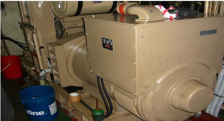
圖 4 「海研一號」研究船新發電機(2部)
