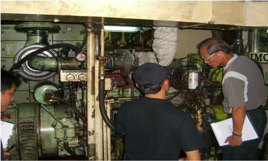
圖 3 全盛工程公司工程人員勘查及計畫拆除舊有發電機情形
